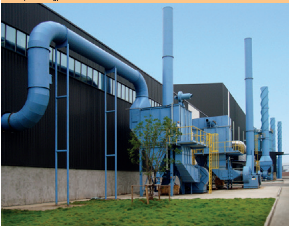
Filtersystem vid gjuteri.
